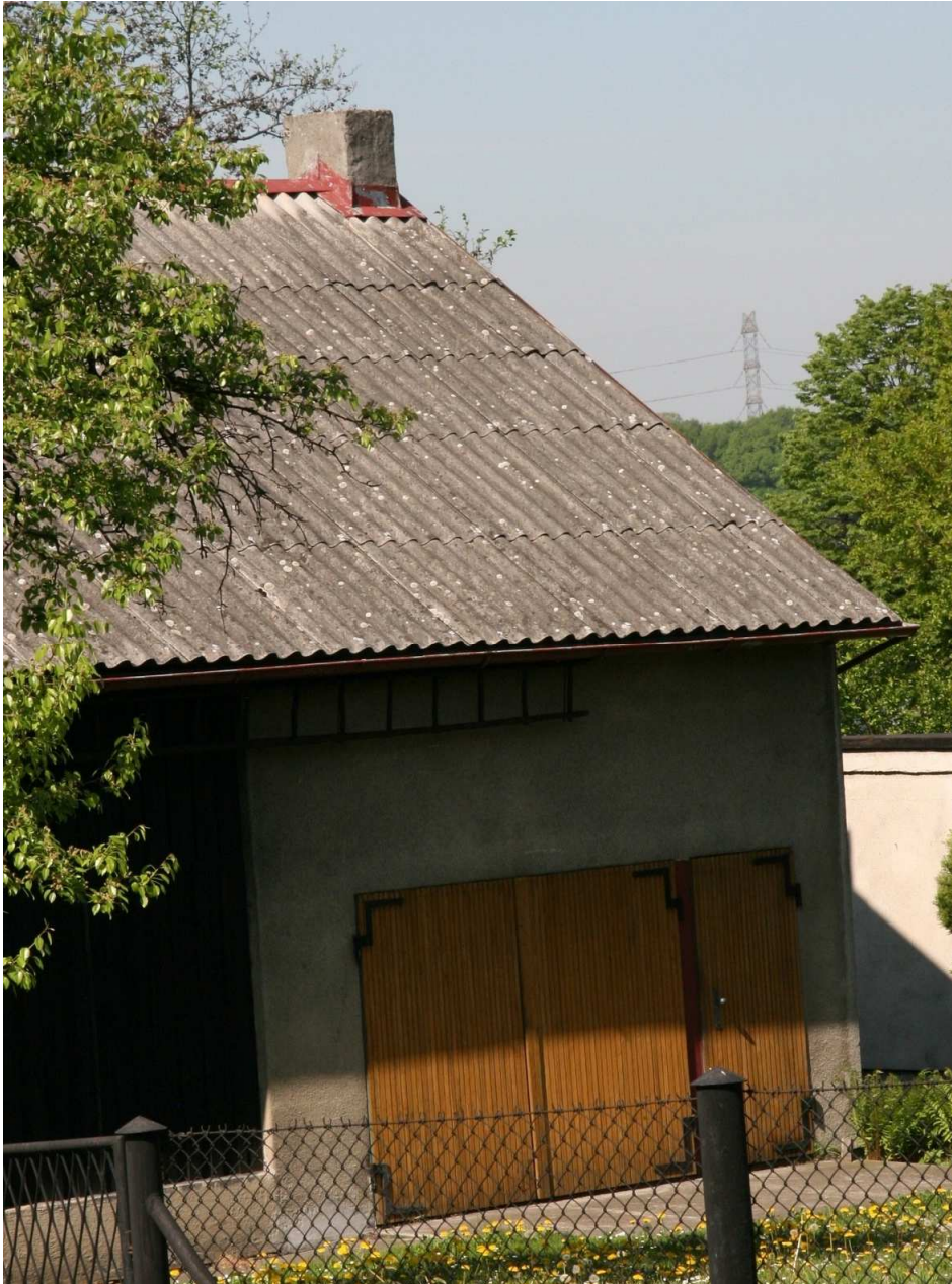
Rysunek 3 Dach pokryty płytami azbestowymi falistymi
