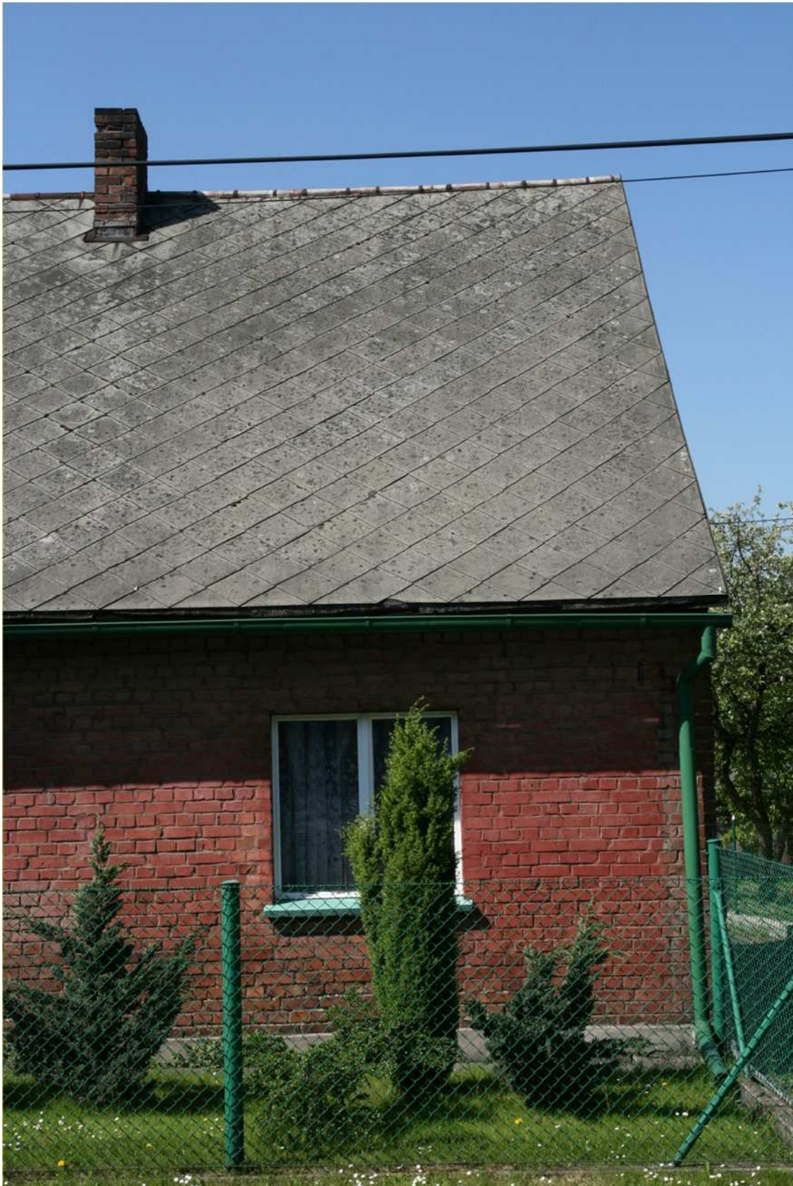
Rysunek 7 Dach budynku mieszkalnego pokryty płytami azbestowymi płaskimi Fotografia Agnieszka Chylak
