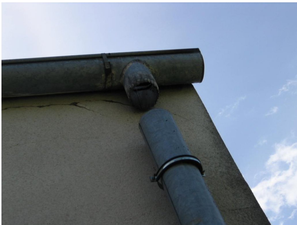
Fot.16. Uszkodzona rura spustowa i ściana w strefie okapu
