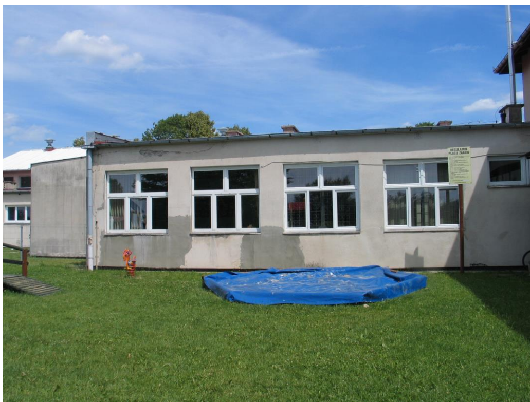
Fot.6. Pawilon ZAK- elewacja zachodnia (widoczne duże uszkodzenia ściany w strefie stropodachu i cokołu)
