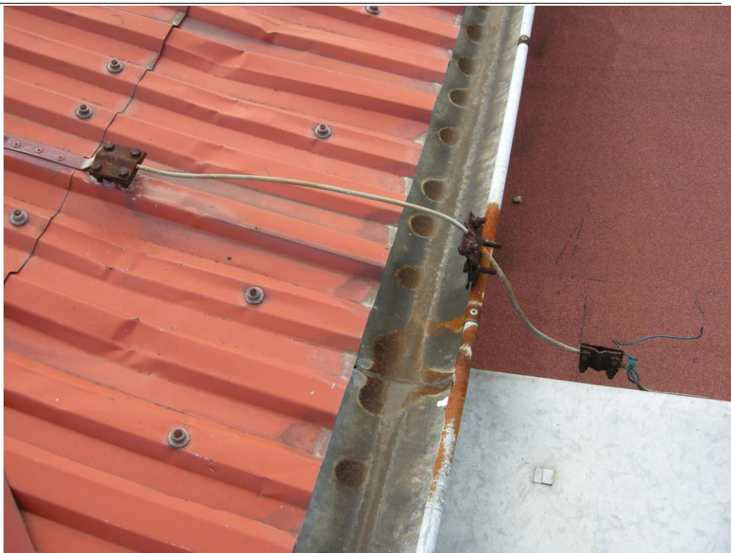
Fot.21 Dach ZDM– skorodowana rynna, pocięta blacha trapezowa mocowana gwoździami
