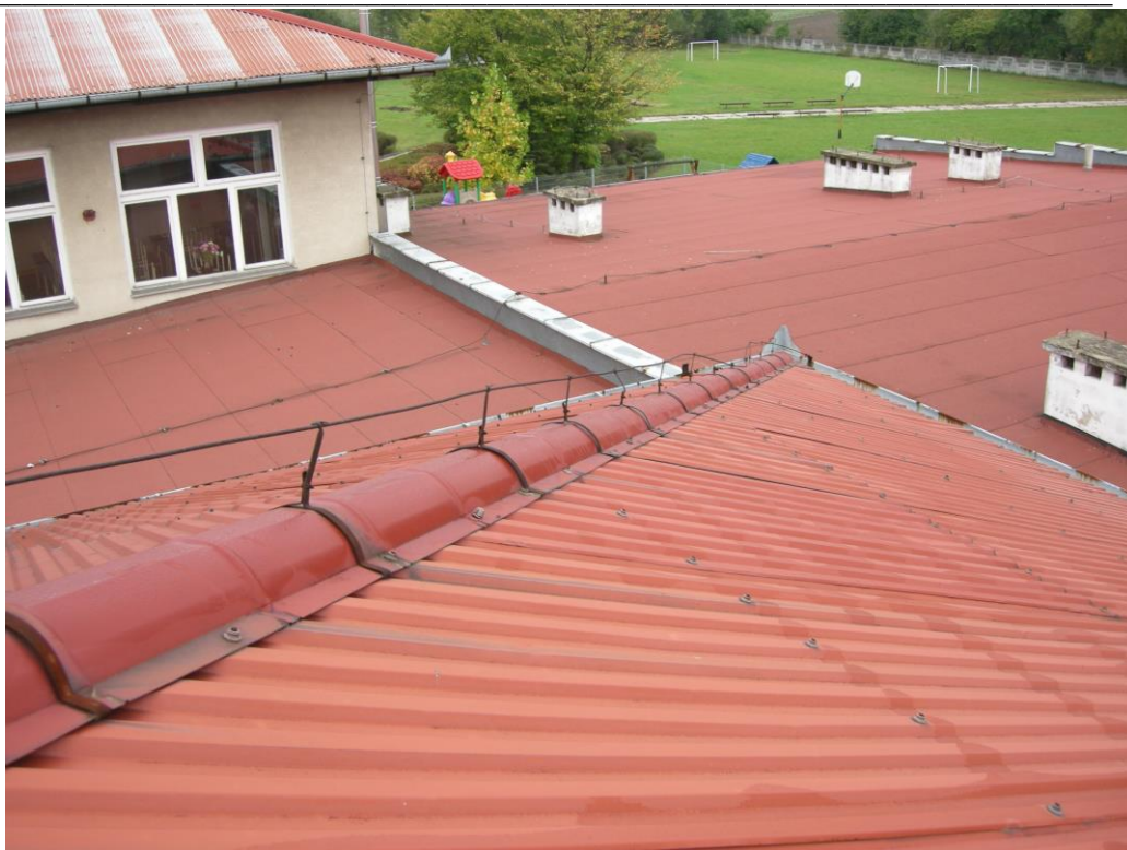
Fot.17. Dachy ZDM, ZDS i ZAK – skorodowana instalacja odgromowa
