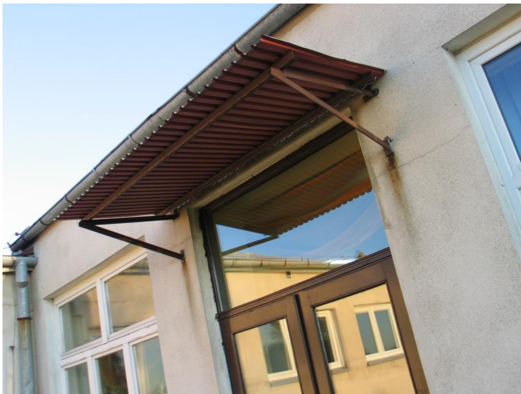
Fot.24. Pawilon ZAK – daszek nad wyjściem północnym (do wymiany), rysy na ścianie
