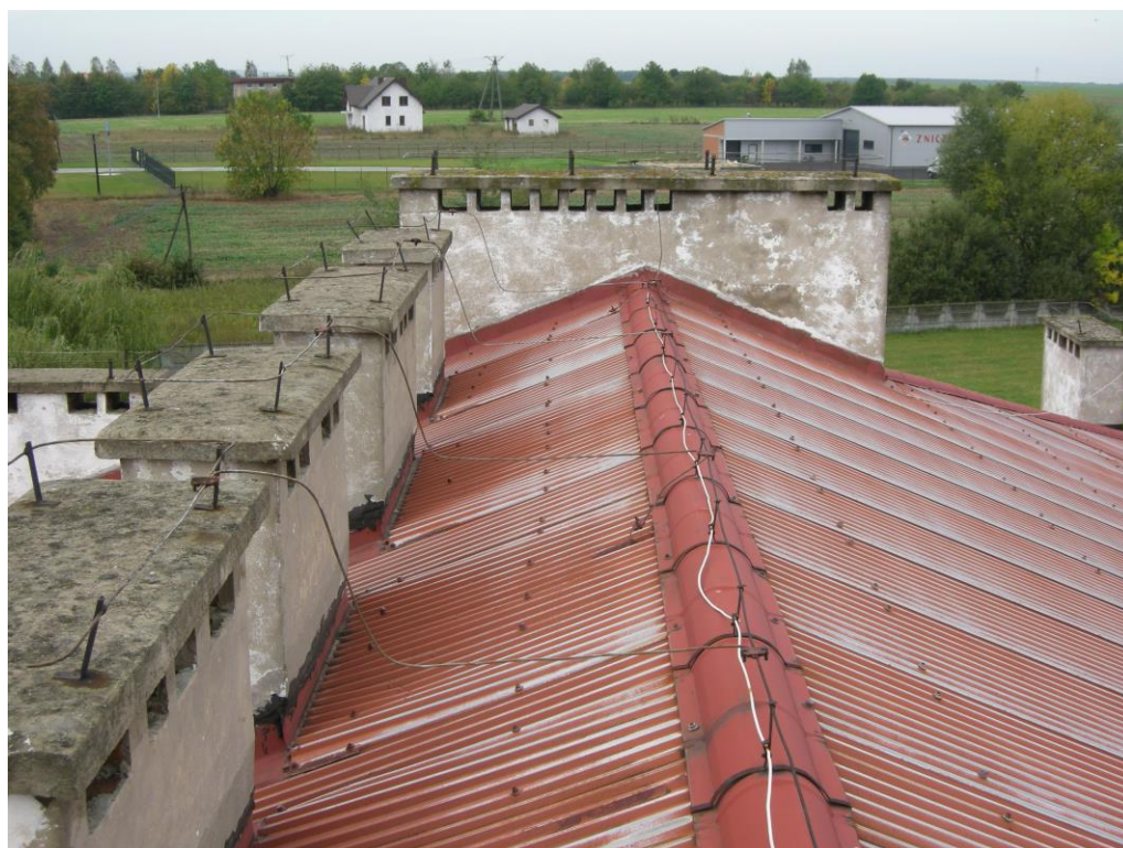
Fot.20. Dach ZDS – odbarwiona blacha trapezowa, stan kominów i instalacji odgromowej
