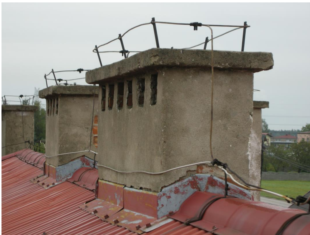
Fot.18. Dach pawilonu ZDM, – stan kominów i instalacji odgromowej
