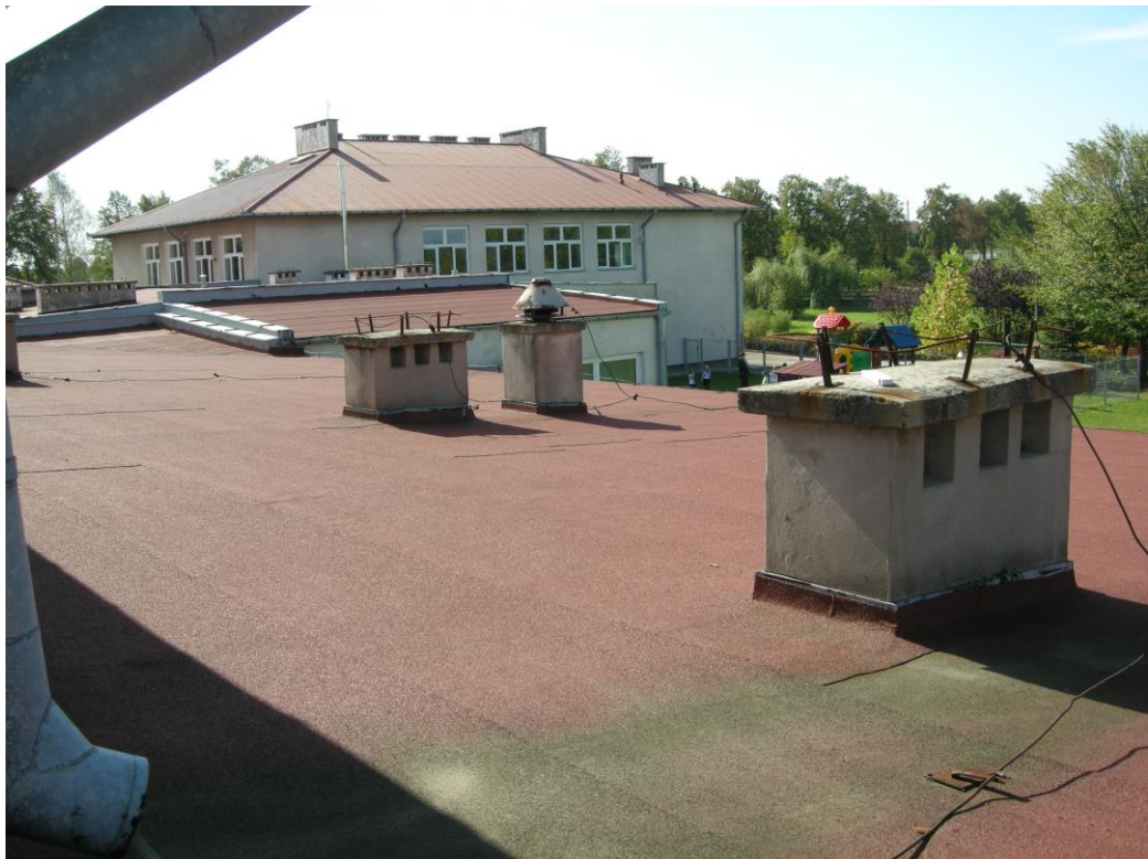
Fot.36. Pawilon ZS – trzony kominowe, uszkodzona instalacja odgromowa
