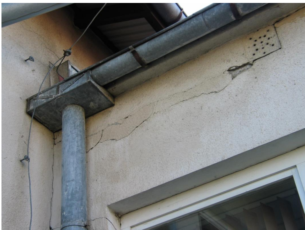
Fot.22. Pawilon ZAK – uszkodzona ściana w strefie okapu
