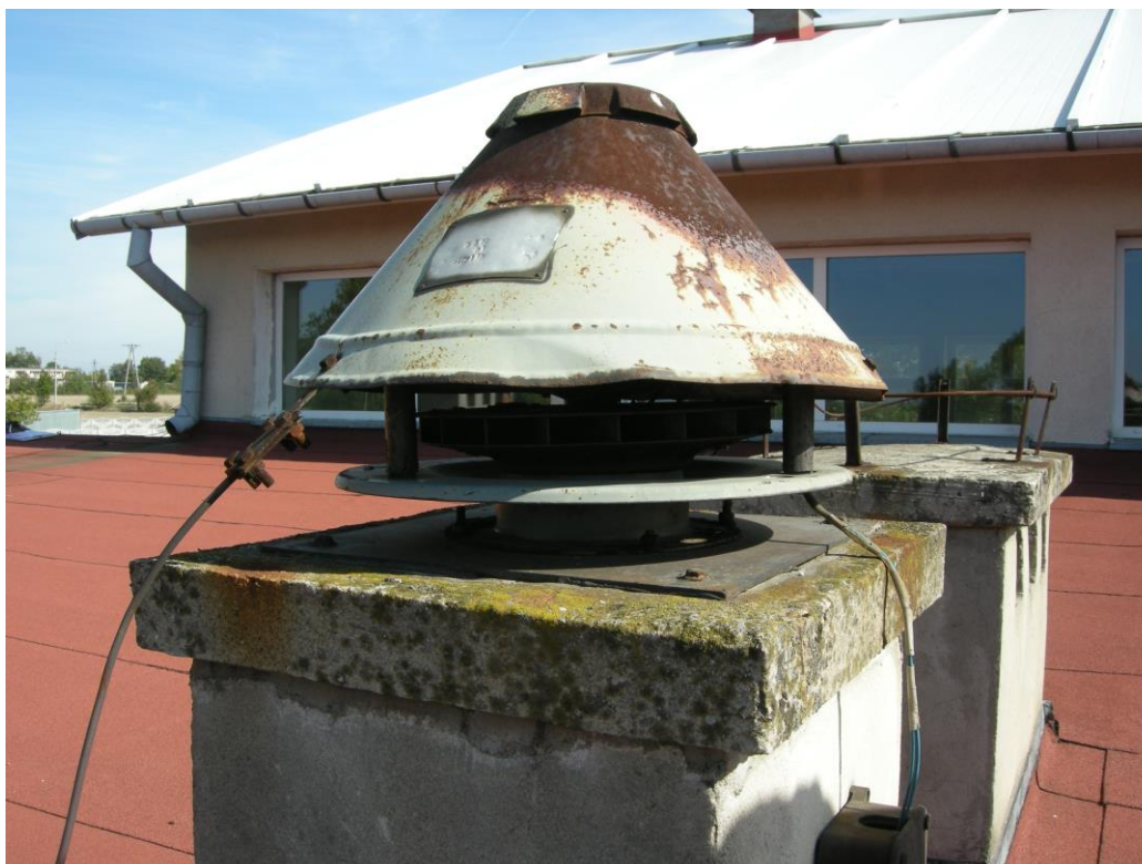
Fot.34. Pawilon ZS – zepsuty i skorodowany wentylator dachowy obsługujący szatnie, zniszczona instalacja elektryczna
