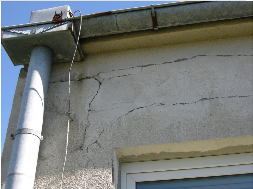
Fot.25. Pawilon ZAK – uszkodzona ściana zachodnia w strefie okapu skorodowane haki rynnowe, zdewastowana instalacja odgromowa
