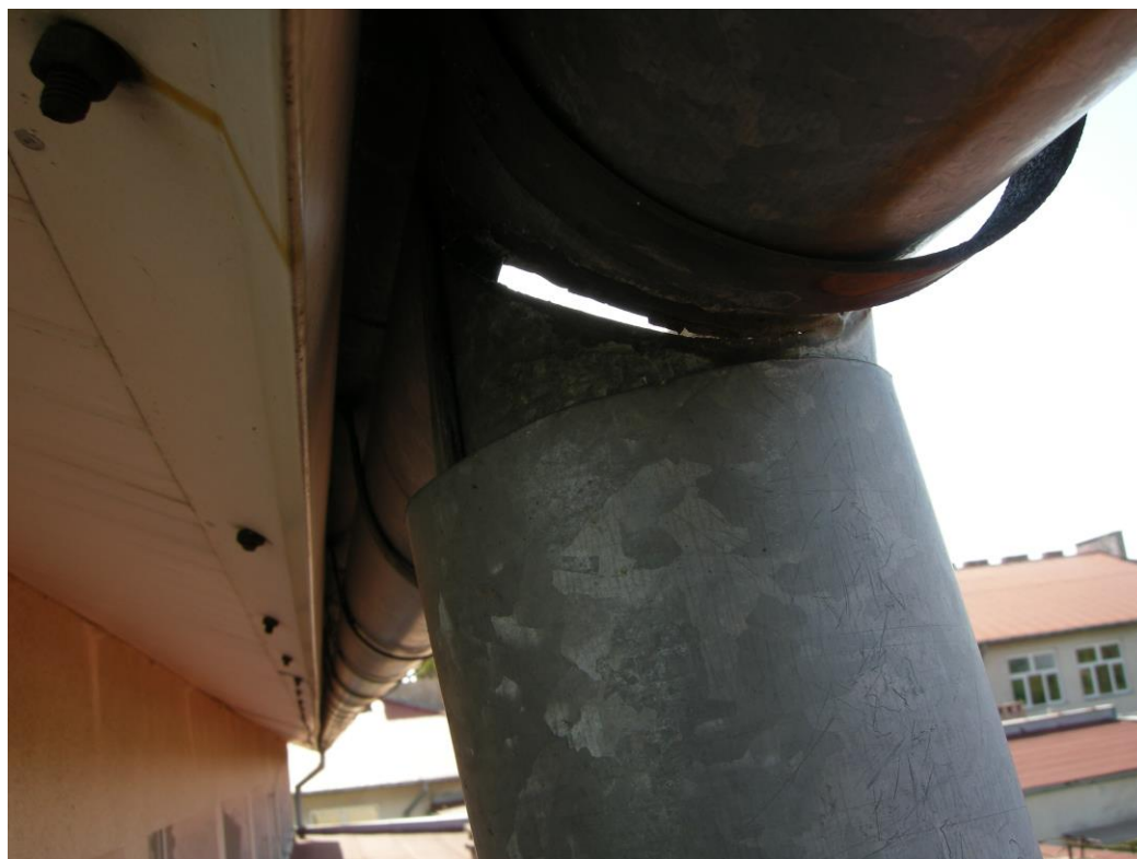
Fot.32. Pawilon ZS – uszkodzona rynna przy rurze spustowej, skorodowane haki rynnowe i śruby mocujące
