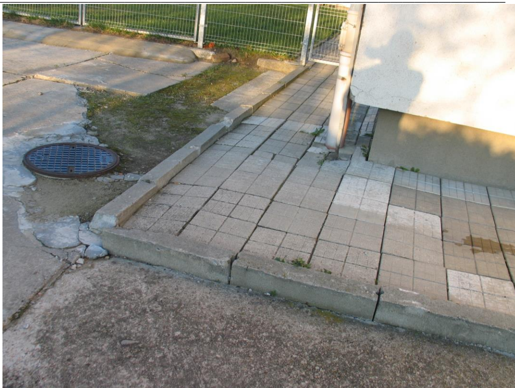
Fot.23. Pawilon ZDS – zapadnięty chodnik przy dojściu do przedszkola
