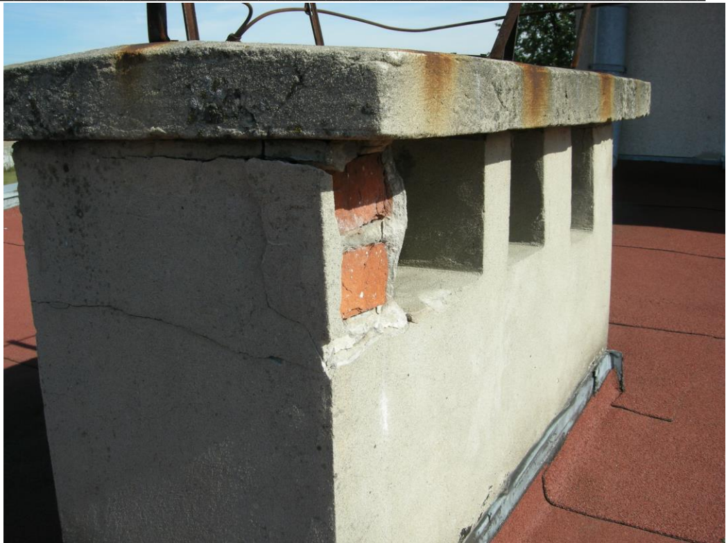
Fot.35. Pawilon ZS – uszkodzony trzon komina wentylacyjnego
